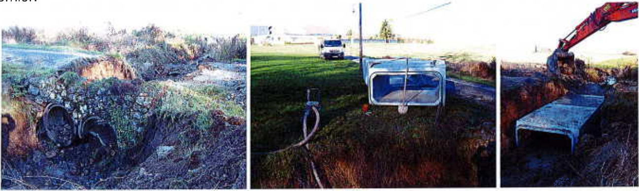
Dépose de l'ancien busage et mise en place des cadres en béton
