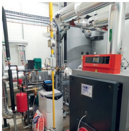
La chaufferie après son entretien annuel
